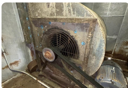
Before Fan Array Retrofit
