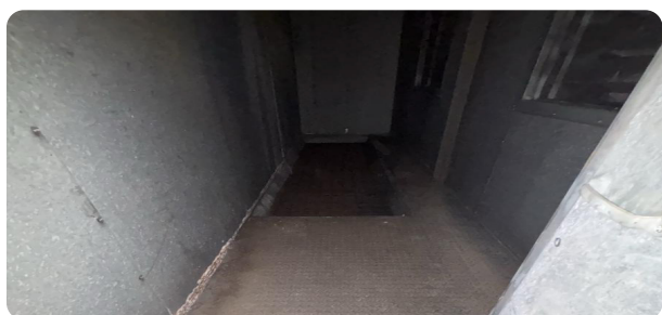
Fan Array Before
